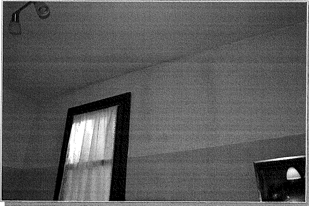
Foto 9 – Scorcio del bagno con le problematiche di condensa interna
